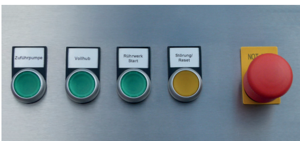
Separates Bedienpanel für das Rührwerk und die Füllerpumpe
